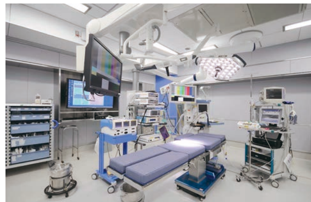
第1手術室 全室シーリングペンダント設置
